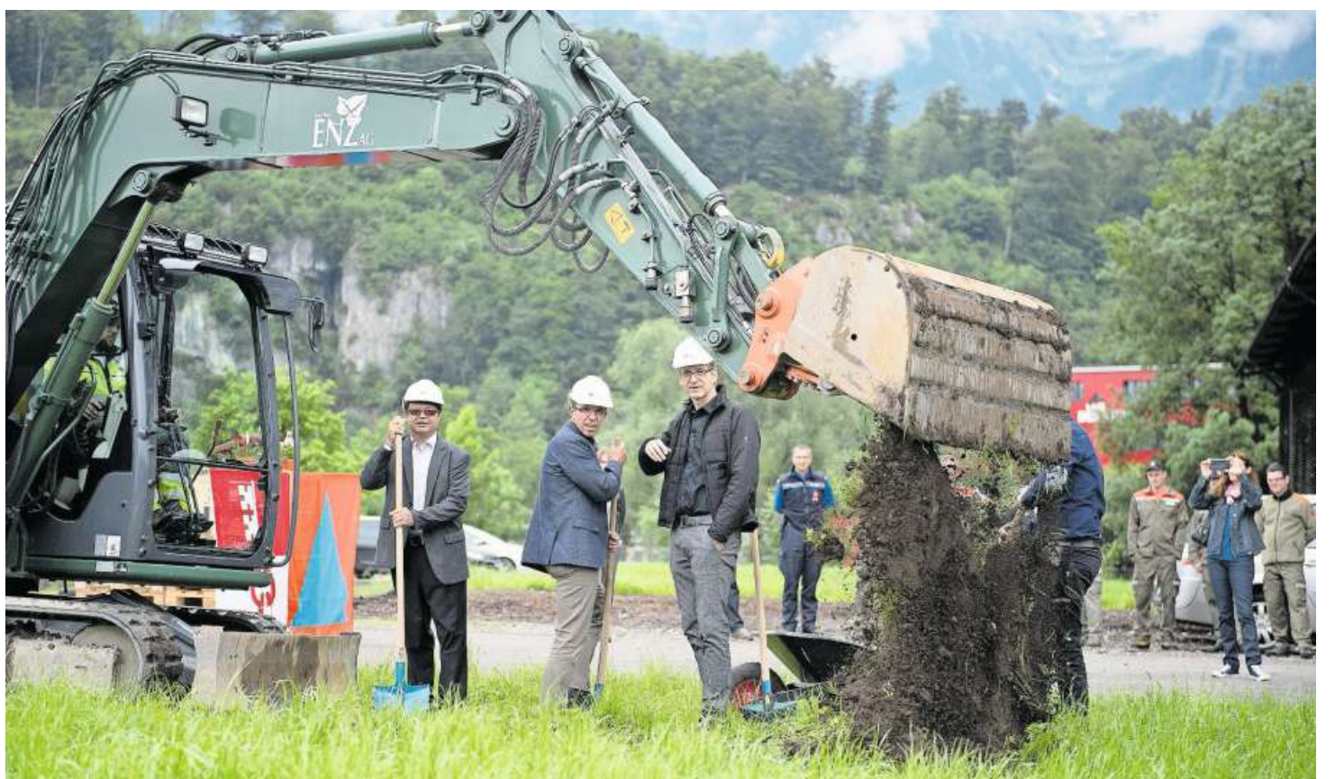
Die Regierungsräte Josef Hess und Christoph Amstad sowie Architekt Pascal Häller (von links) erhalten beim Spatenstich Unterstützung durch einen Bagger. Bild: Corinne Glanzmann (Kägiswil, 23. Mai 2018)
